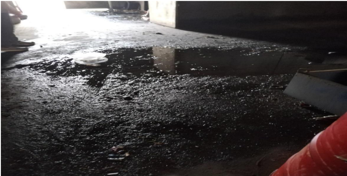
شكل (١) تآكل أرضية المحطة من الداخل وهي مغطاة بعصارة النفايات المصدر : الباحثين الدراسة الميدانية ، ٢٠٢٢
