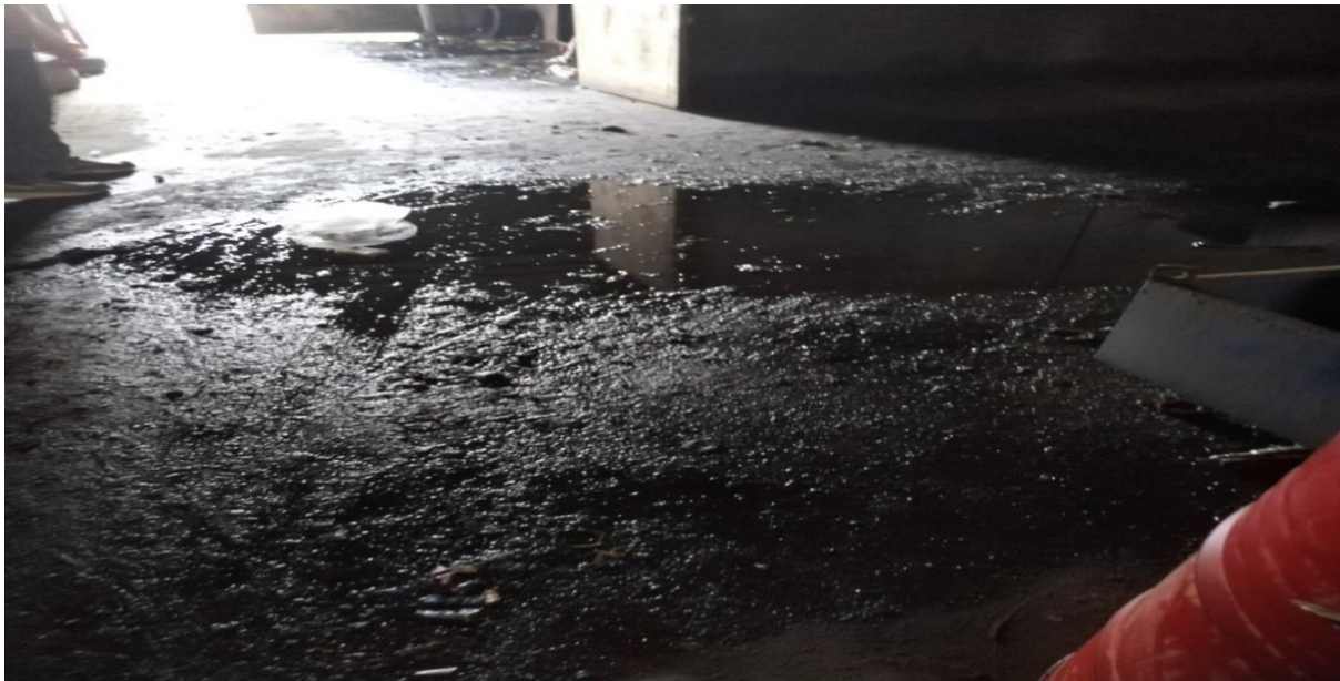
شكل (١) تآكل ارضية المحطة من الداخل وهي مغطاة بعصارة النفايات المصدر : الباحثين الدراسة الميدانية ، ٢٠٢٢
